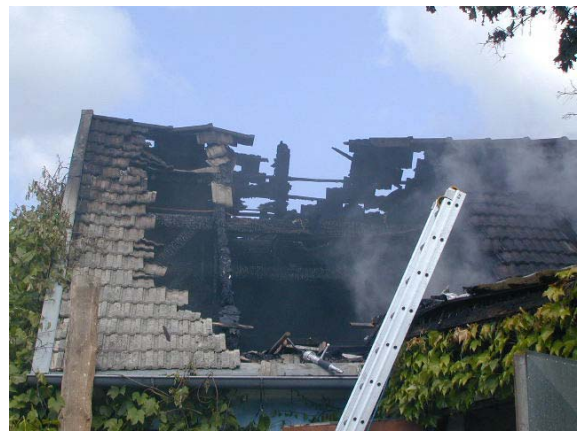
2004 – Heizraumbrand bei Erwin Hofbauer in Göpfritz
